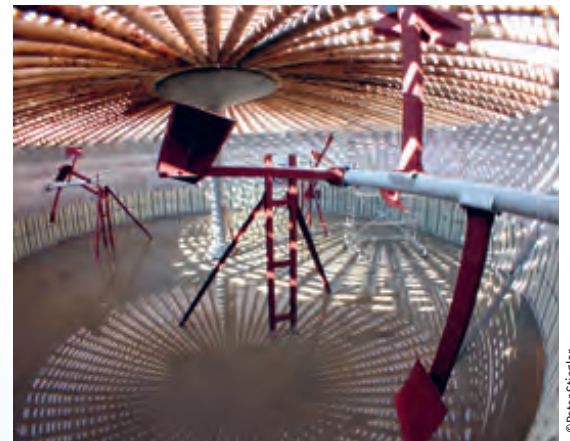
Ein Blick in das Innere der Biogasanlage.
